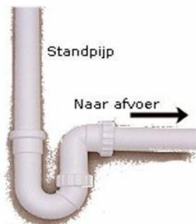
opening waar afvoerslang waterontharder ingehangen kan worden
